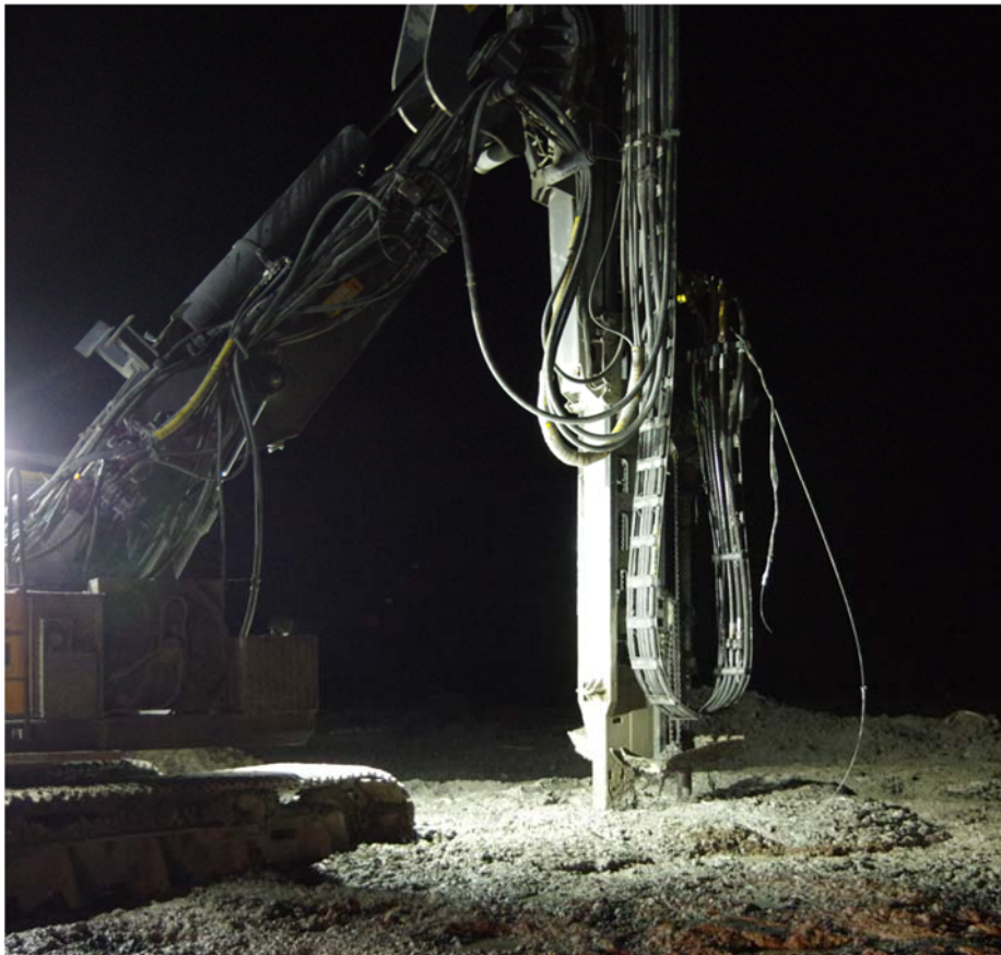
Figur 33. Installation av elektrodkabel i centrum av KC-pelare i Bålsta (Foto: Torleif Dahlin).
